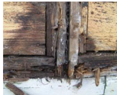
Photo 5 : pourrissement d'une ossature bois - source Afordex
