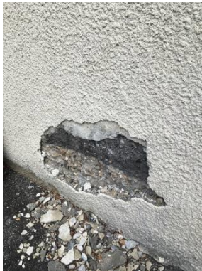
Photo 3 : Eclatement d'un enduit imperméable sur mur mâchefer - rue Valensaut, 11.2018
