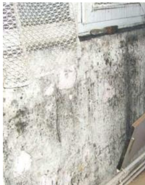
Photo 4 : Moisissure sous menuiserie - Dauphiné - Diag technique L. Aydstian mars 2010
