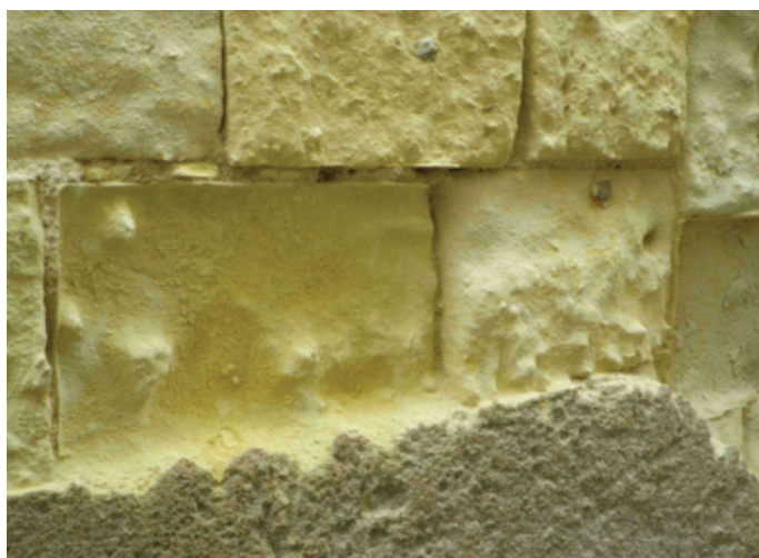
Figure 25 : Pierres de taille en tuffeau dégradées par alvéolisation au-dessus du soubassement. Celui-ci a été enduit de ciment, empêchant le séchage de l'eau liquide et gênant le passage de la vapeur d'eau.
