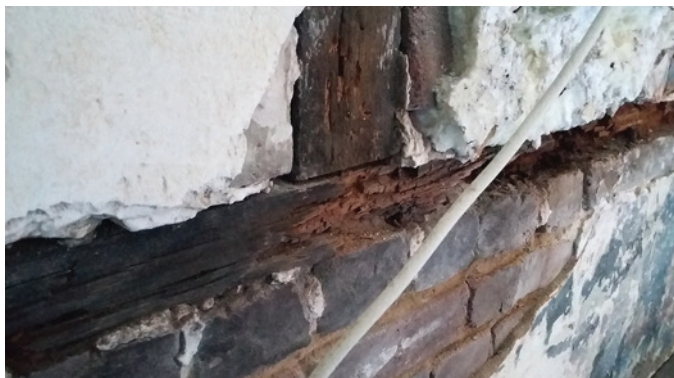
Figure 4 : Illustration des enjeux techniques associés aux risques de pathologie après réhabilitation énergétique – Pourriture du bois observée après dépose d'un isolant
