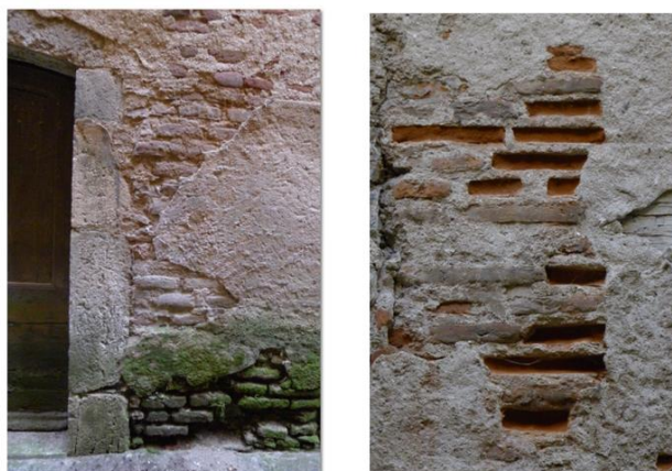
Figure 2 : Désordres observés sur des façades extérieures cadurciennes : (gauche) chute de l'enduit cimentaire, délitement du mortier de soubassement et apparition de mousse, (droite) délitement de la brique
