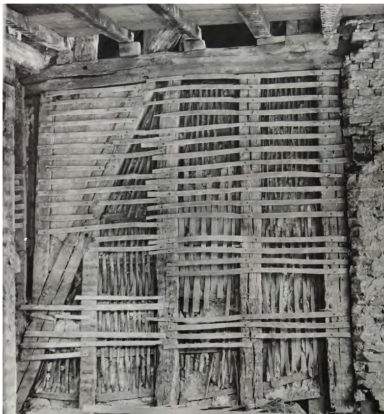
Illustration 25: Une paroi avec une combinaison de deux types de support de fixation, clayonnage vertical entre bois d'ossature, lattis horizontal sur le colombage (© Médiathèque de l'architecture et du patrimoine (Centre de recherche des monuments historiques - CRMH) diffusion RMN Daniel Bontemps
