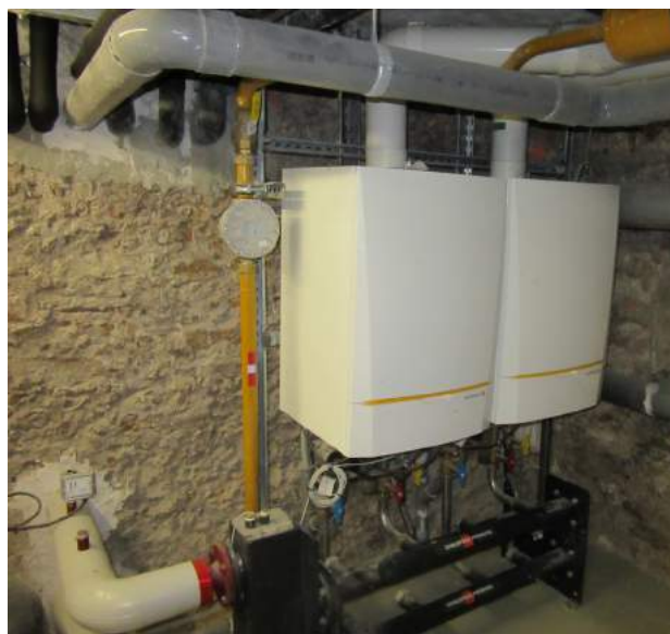
Chaudières à condensation gaz en sous-sol © Ekopolis
