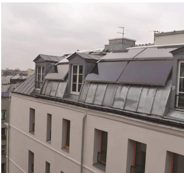
Panneaux solaires thermiques © F+L architectes
