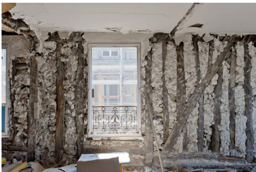
Structure en pans de bois, plâtre et gravas © Jean-Claude Pattacini pour la Siemp
