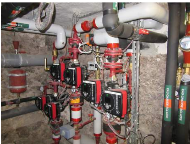
Réseau de distribution de chaleur en sous-sol © Ekopolis
