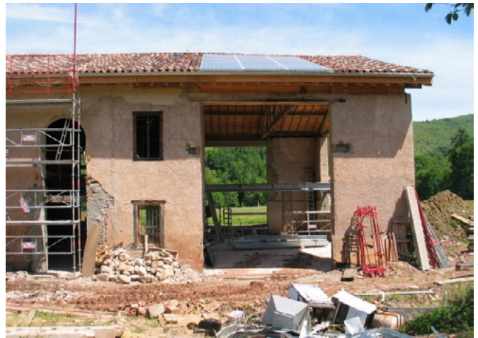
Panneaux solaire sur le pan sud de la toiture
