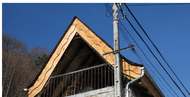
L'isolation en sur-toiture a imposé une surépaisseur et des planches de rive disproportionnées pour une couverture en ardoises qui se veut assez fine.
