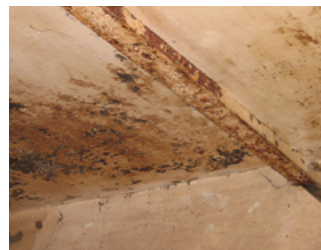
Traces d'humidité sur les plafonds
