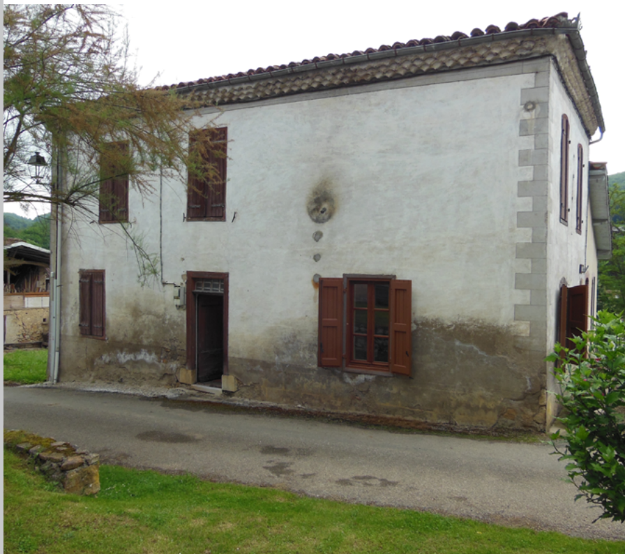
Remontées d'humidité au niveau du soubassement de la maison
