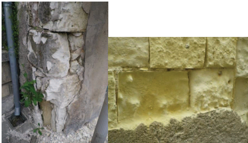
Fig. 2.2 : Altérations liées à la présence d'enduits ciments (photo : auteure)
