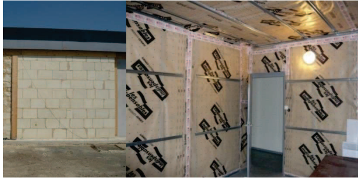
Fig. 4.7 : Droite : vue de la façade extérieure – Gauche : vue intérieure (isolant) de la cellule expérimentale
