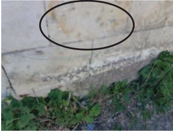
Fig. 1.13 : Efflorescences – Bâtiment n°1 (Source : auteure)
