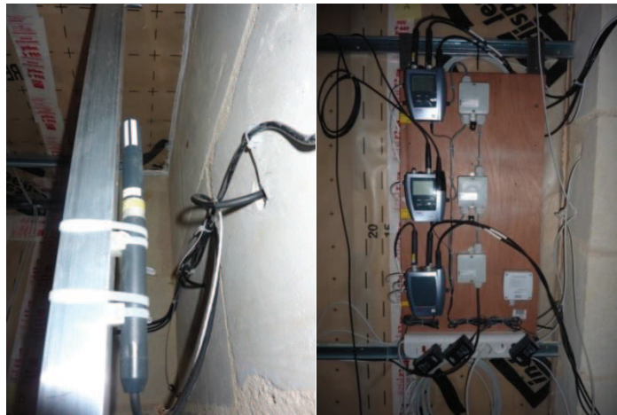
Fig. 4.9 : Droite : Capteurs de température et humidité relative d'ambiance - Gauche : Centrales d'acquisition des données
