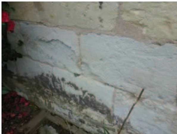
Fig. 1.12 : Détachement en plaques – Bâtiment n°1 (Source : auteure)
